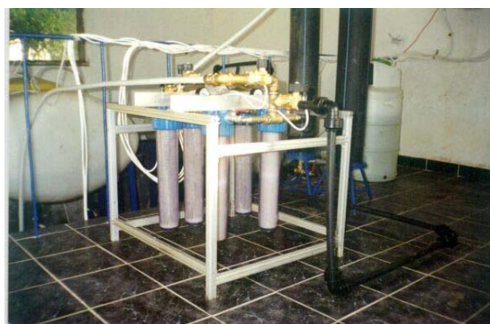
Instalație membranară îmbunătățită (cu membrane solide) la nivel de pilot de purificare a apei reziduale
